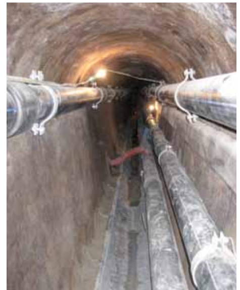
Platzeffizient: In größeren Kanalsystemen können neben Wärmetauschern auch Telefon-, Glasfaserkabeln und Fernwärmeleitungen in einem Rohr verlegt werden.
